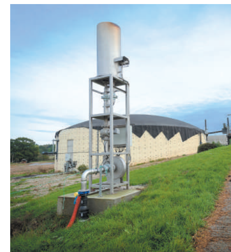
La torche est mise en fonctionnement pour des raisons environnementales et de sécurité lorsqu'il faut détruire le biogaz.
